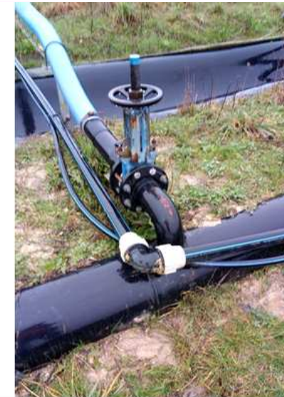
Réseau lixiviat et amenée d'air comprimé installés le long du réseau biogaz existant
